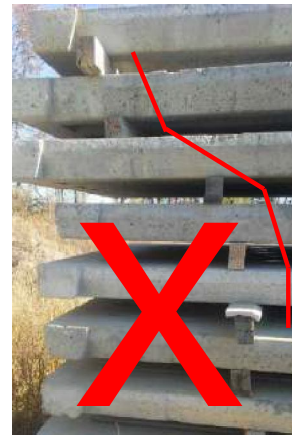
Ubicación incorrecta de la madera de estiba
